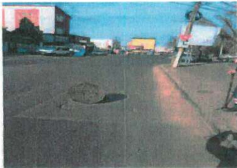
CCG2 placa la nivel asfalt si exfolieri
